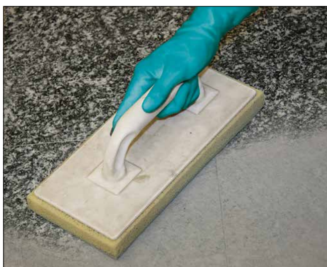
6 Nettoyage des dalles de pierre naturelle après prise suffisante du Joint Sopro.
