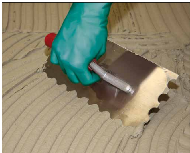
1 Application du Mortier colle épais Sopro VarioFlex® XL sur la couche de contact.
